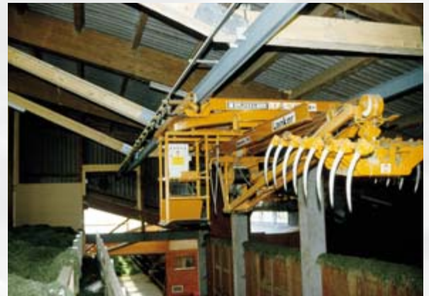
Die Holztragkonstruktion verändert mit den Jahren die Grösse. Die Schienenaufhängung und die Schraubenspannung müssen daher kontrolliert werden.
